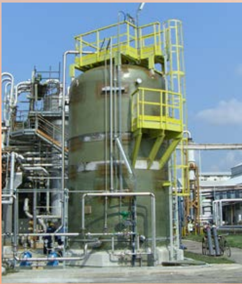
GAP lagringstank komplett med stege och landgång av GAP
